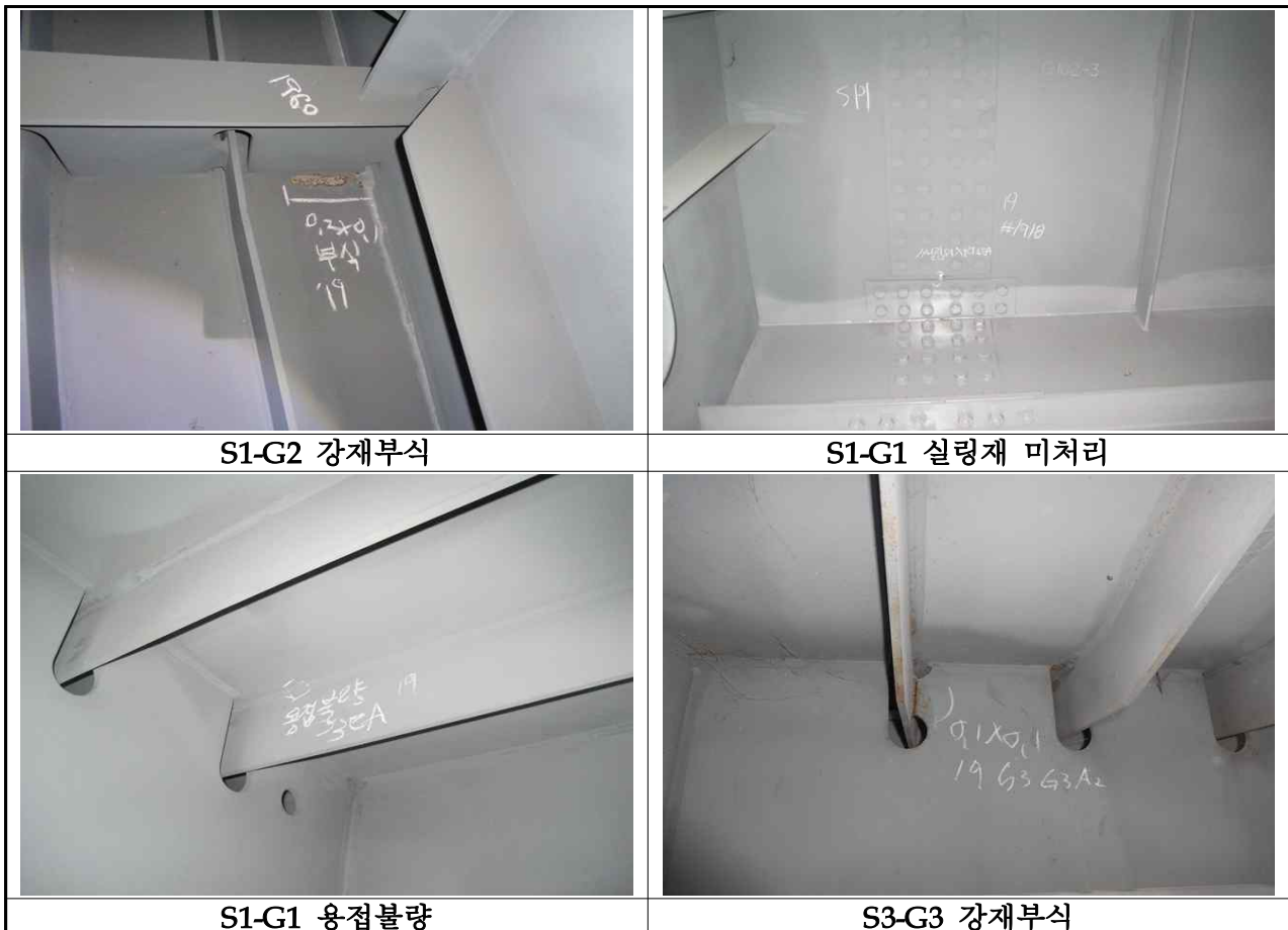
【사진 3.6】 거더 내부 손상현황
