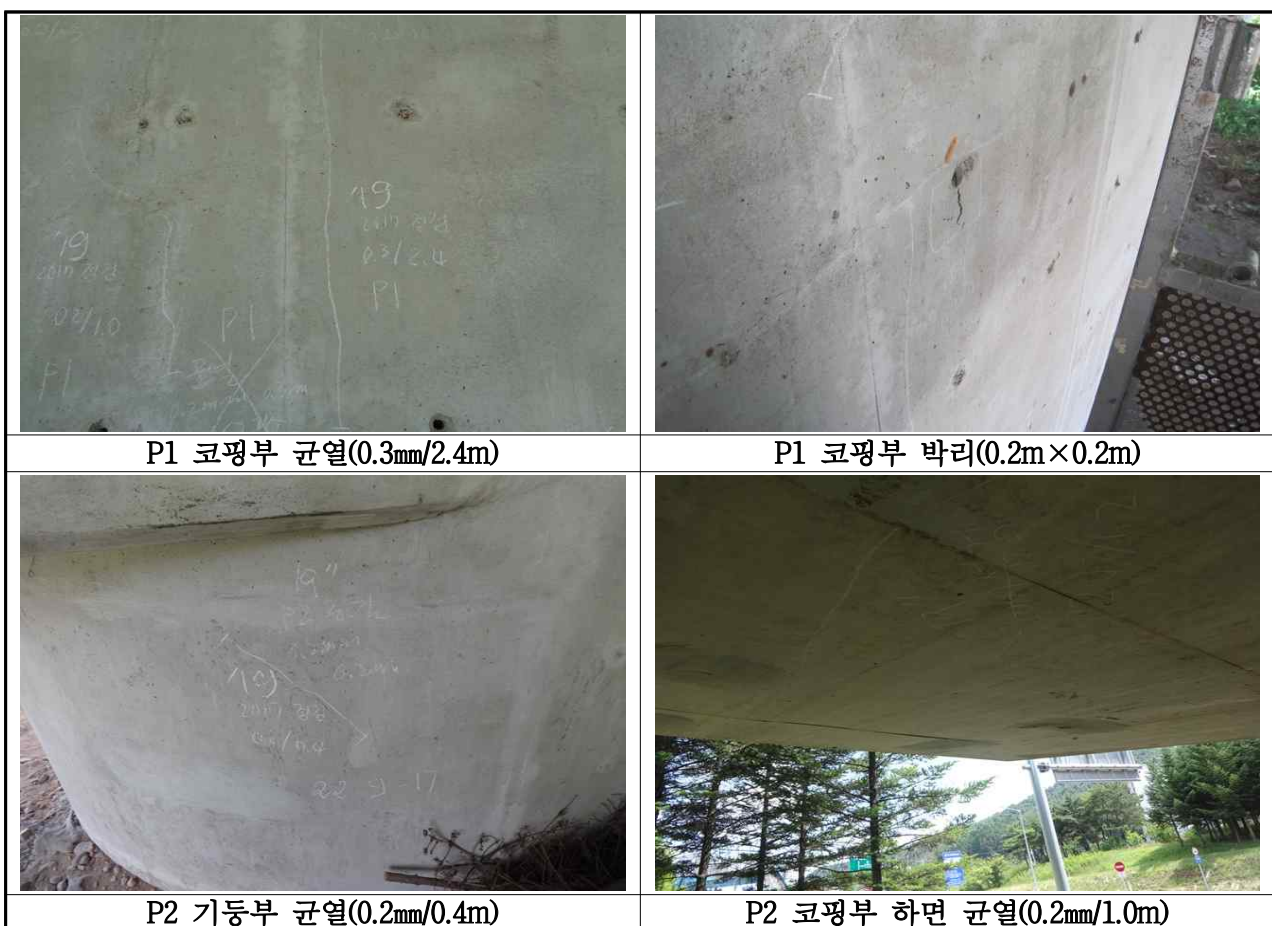
【사진 3.12】 교각 손상현황
