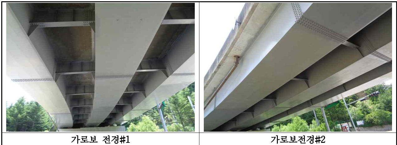
【사진 3.7】 거더 내부 손상현황
