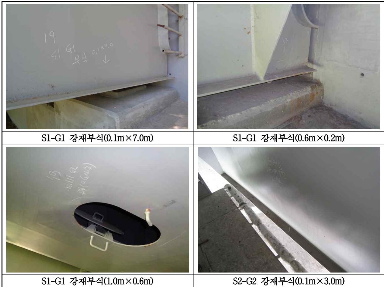
【사진 3.5】 거더 외부 손상현황
