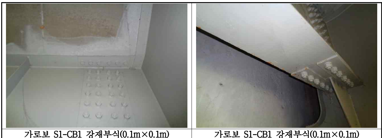
【사진 3.8】 가로보 및 세로보 손상현황
