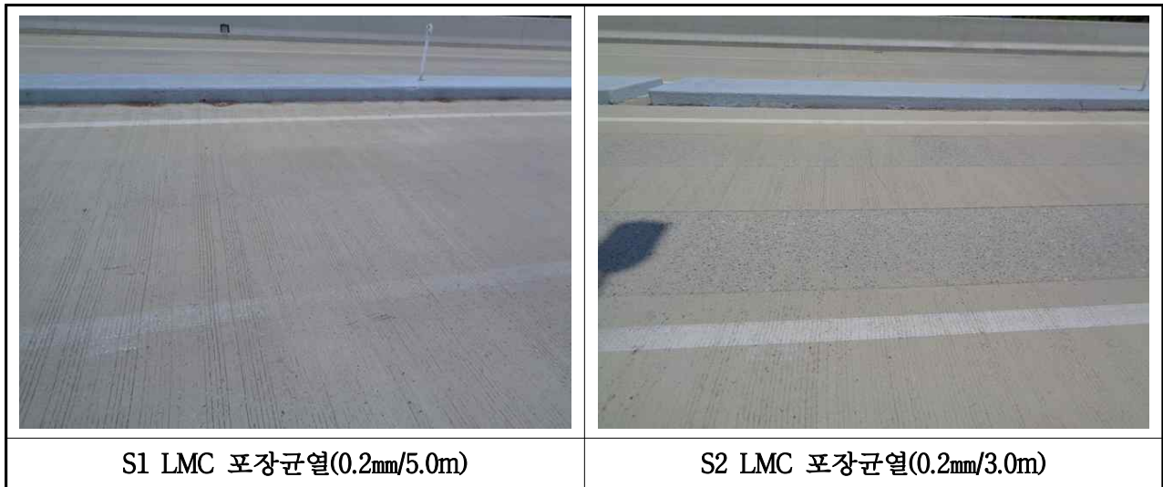
【사진 3.20】 교면포장 손상현황
