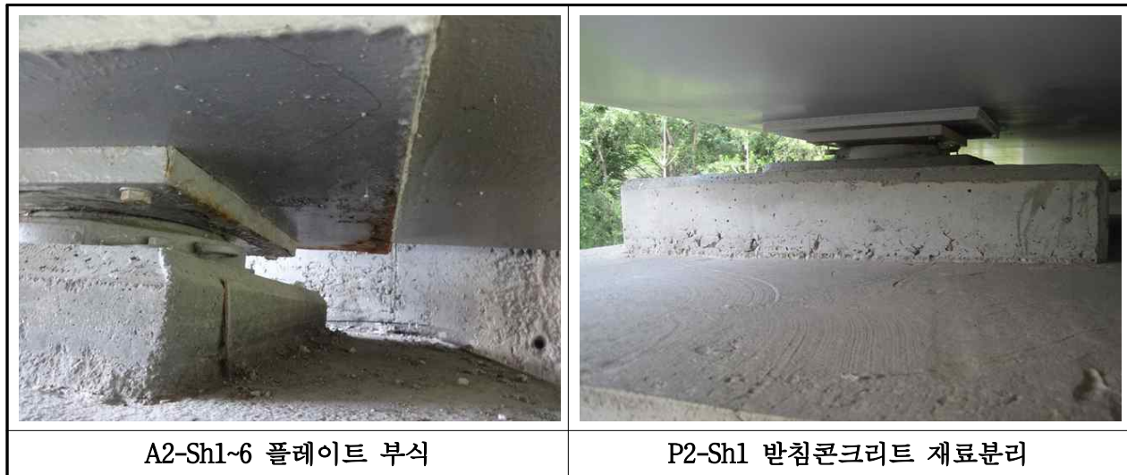
【사진 3.14】교량받침 손상현황(계속)
